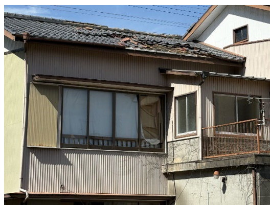
④ 木造住宅屋根ふき材のはく離（南から北に撮影）
