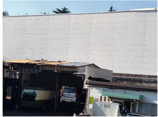
② 車庫及び店舗の屋根ふき材のはく離（南東から北西に撮影）
