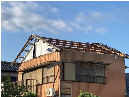
⑪ 木造住宅の小屋組の損壊（南から北に撮影）
