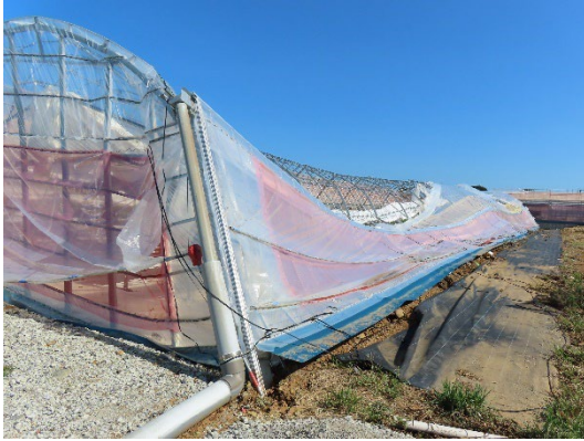
⑦ パイプハウスの倒壊（北から南に撮影）
