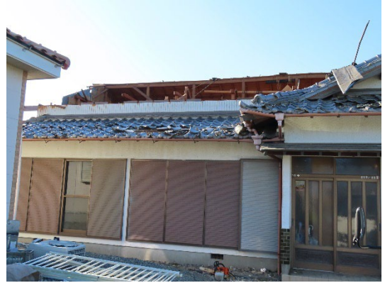
⑧ 木造住宅の小屋組の損壊（南東から北西に撮影）
