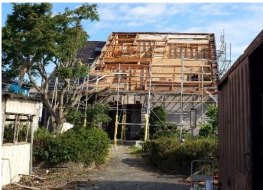
③ 木造住宅の小屋組の損壊（北西から南東に撮影）
