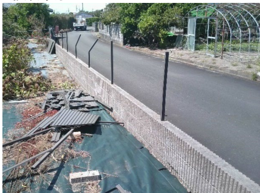
① フェンスの損壊（南東から北西に撮影）
