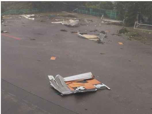
③ 鉄骨系店舗からの屋根ふき材の飛散（静岡県立伊豆伊東高等学校提供）
