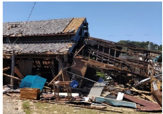
④ 木造住宅の倒壊（南東から北西に撮影）
