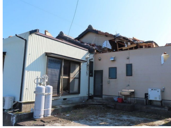
② 木造住宅の小屋組の損壊（北から南に撮影）
