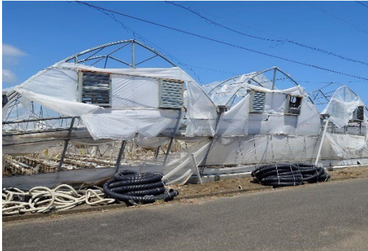
① パイプハウス鋼管の変形（南から北に撮影）
