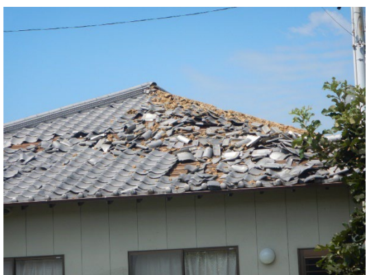
③ 木造住宅屋根ふき材のはく離（東から西に撮影）
