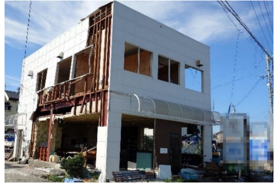
② 鉄骨系店舗の外壁材のはく離（南から北に撮影）
