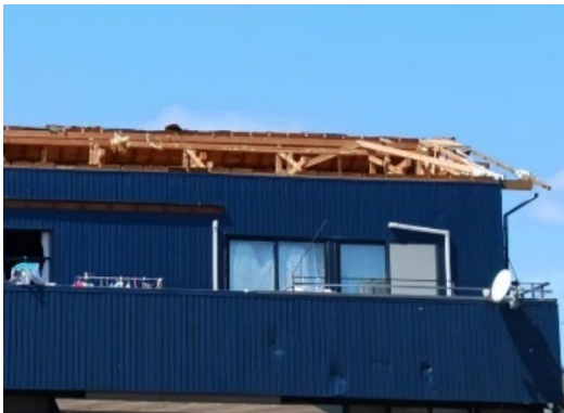
⑤ 木造住宅の小屋組の損壊（南東から北西に撮影）
