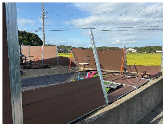
⑥ フェンスの倒壊（南東から北西に撮影）
