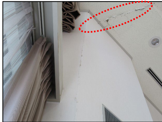
写真2 天井材の落下 (階上町道仏)
