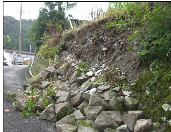
写真6 伊豆市西平地区の石垣 石垣崩落（伊豆市市山観測点の南約1.2km 付近） 西平地区で石垣が崩れ道路にまでかかっていた。
