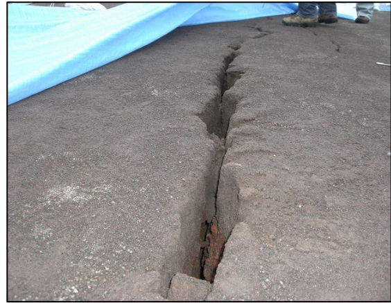
写真4 伊豆市天城中学校のグラウンド 地面の亀裂（伊豆市市山観測点の北2km 付近） グラウンド北側長さ約80m、幅約20mの範囲に地 割れが数箇所発生
