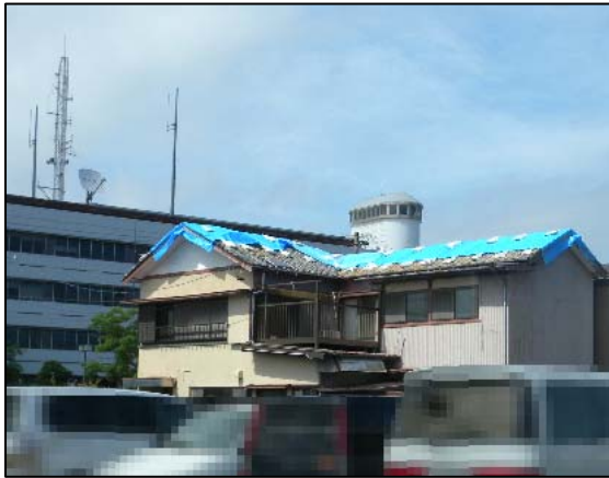
写真3 牧之原市相良震度観測点付近 屋根瓦が落下しブルーシートで補修
