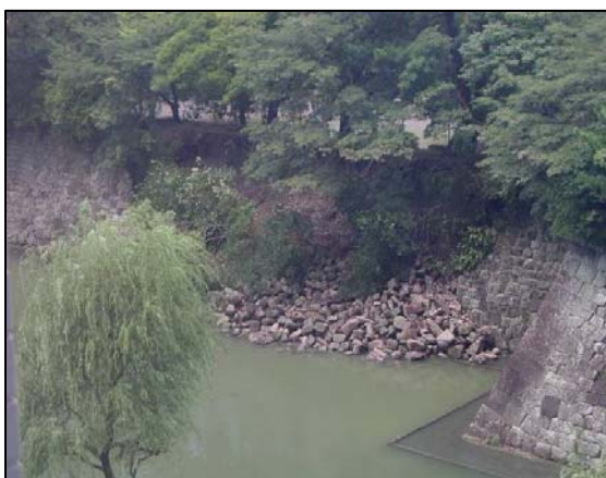
写真7 静岡市葵区駿府城跡 石垣が崩落（静岡葵区駒形通観測点の北東1.6km 付近）
