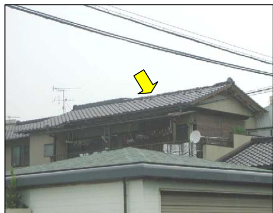
写真8 静岡駿河区曲金震度観測点付近 屋根瓦が破損（矢印箇所）
