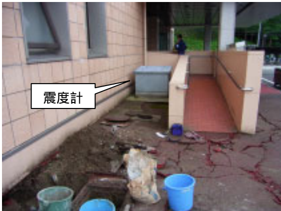
震度計の設置状況(周辺に陥没や亀裂)
