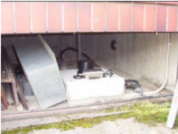
震度計の設置状況(異常なし)
