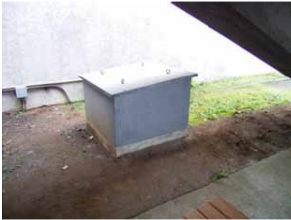
震度計の設置状況(異常なし)
