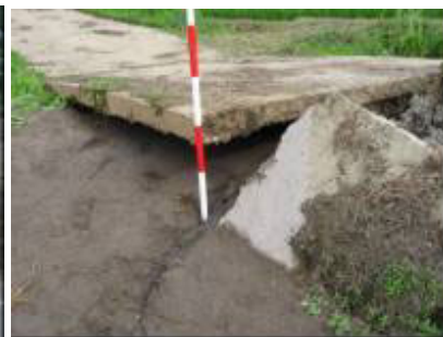
ガスパイプライン埋設の 農道からの砂の流出
