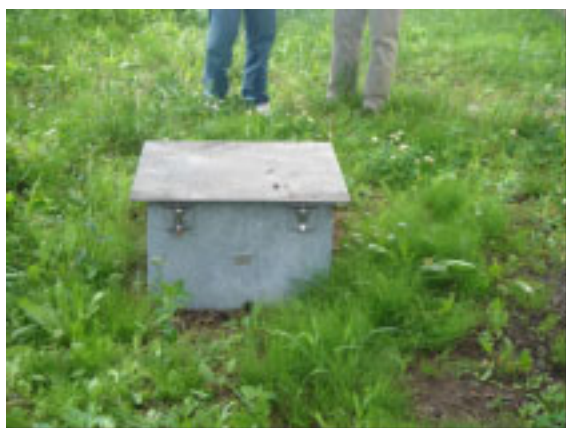
震度計の設置状況(異常なし)
