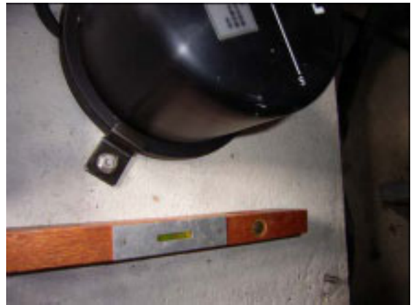
センサーおよび設置台(異常なし)
