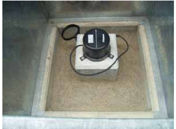
センサーおよび設置台(異常なし)
