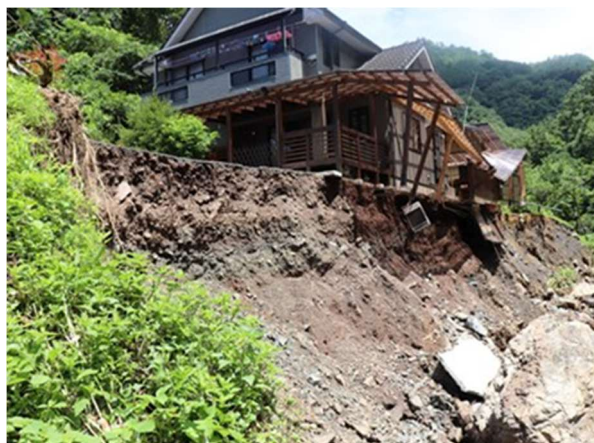
土砂災害で家屋の基礎が露出
