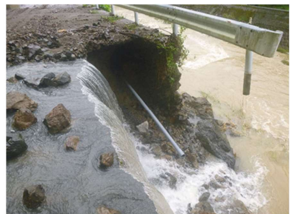
簡易水道配水管(城川町魚成)
