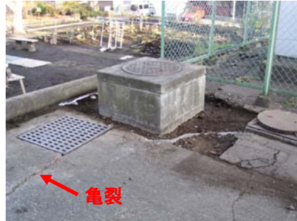
写真2 排水枡コンクリート部の亀裂
