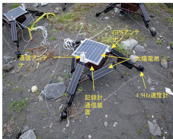
図2 設置した地震計
