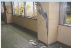
▲ ひび割れた校舎の柱
