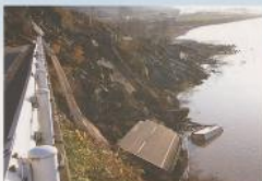
▲ 別所町での土砂崩れ
