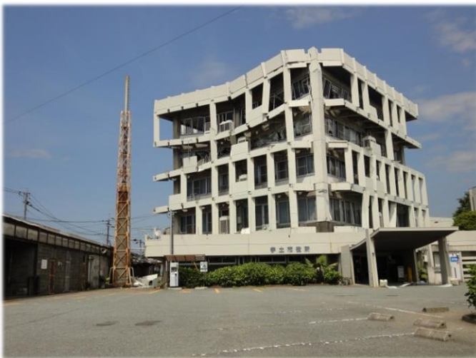
【宇土市役所の被災状況】
