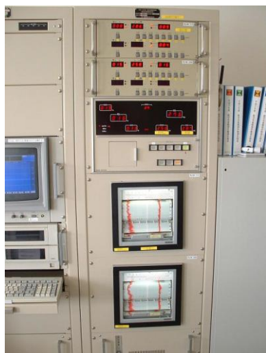
風観測装置（屋内装置）
