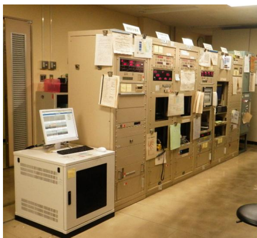
空港気象常時監視通報装置
