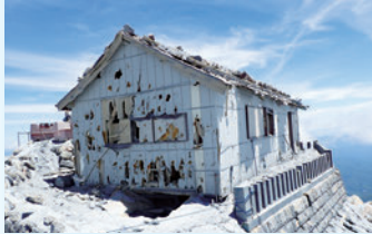
▲御嶽山：噴石で被災した建物（2015年6月10日） 〈御嶽山合同観測班撮影〉
