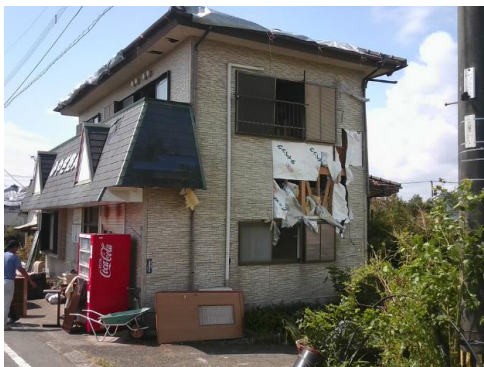
外壁材がはく離した木造住家 (⑦8月29日 宮崎県宮崎市)
