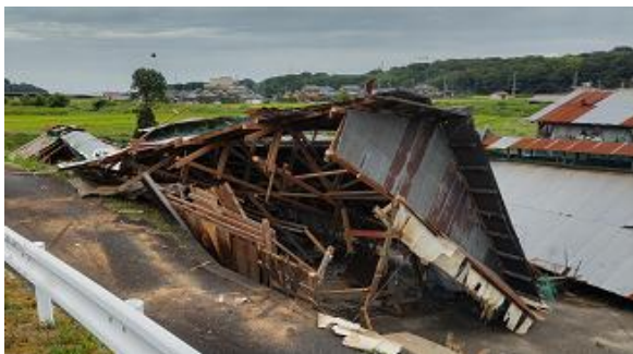
倒壊した旧鶏舎（伯耆町提供） (①8月27日 鳥取県西伯郡伯耆町)
