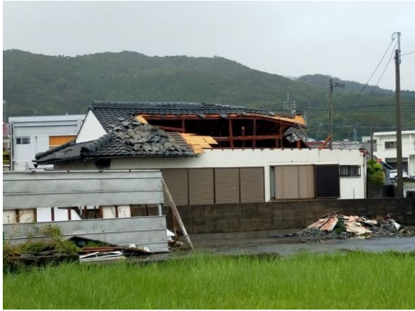
鹿児島県枕崎市の暴風被害 (8/30 撮影 枕崎市提供)
