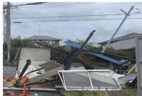
倒壊して飛ばされたプレハブ小屋 ((7)7月4日 静岡県掛川市)
