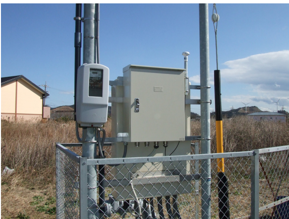
写真 1 伊良湖環境モニター装置 手前の筐体に収納
