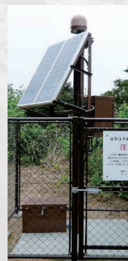
GNSS 観測装置
