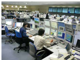
ATMC 運用室内の作業風景
