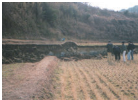
水田に表出した断層(淡路市(旧北淡町))
