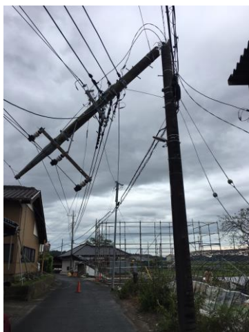
電柱の倒壊による配電設備の故障 (9/9撮影 千葉県多古町提供)
