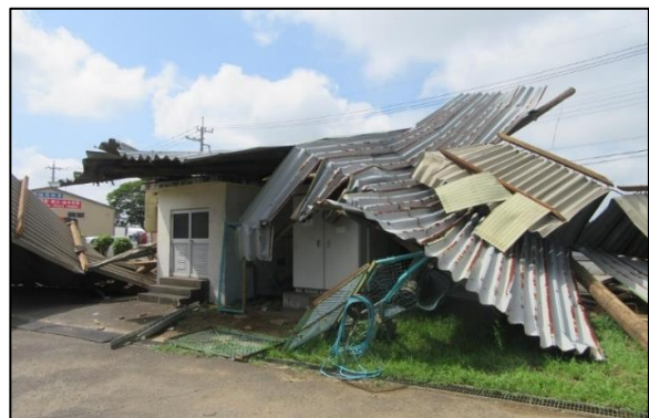
倒壊した倉庫 (茨城県行方市) (8/22 撮影 気象庁職員)
