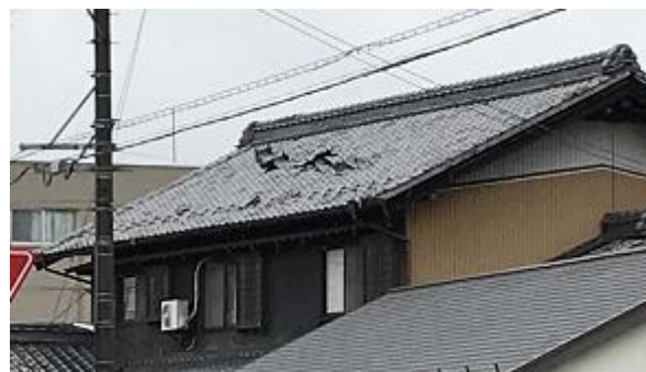
屋根瓦がめくれた住家 (岐阜県羽島郡岐南町 住民提供)
