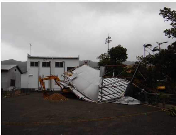
鹿児島県奄美市 暴風による建物の損壊 (9/30撮影 気象庁職員)
