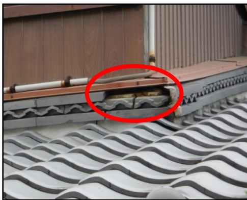
写真3 民家の瓦の落下 (大阪市東淀川区北江口)
