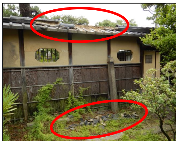
写真6 民家の塀の瓦の落下 (吹田市内本町)
