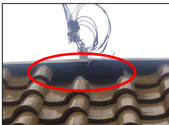
写真12 民家の瓦の落下 (八幡市八幡)
