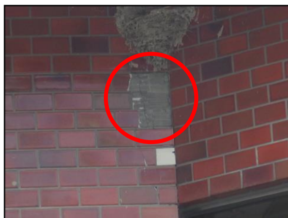
写真1 建物外壁の剥離 (箕面市栗生外院)
