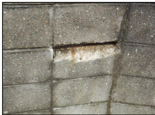
写真4 ブロック塀の剥離 (大阪市東淀川区北江口)
