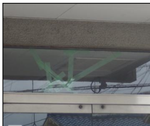
写真2 ガラスのひび (箕面市栗生外院)
