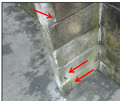
写真9 ブロック塀のひび割れ (寝屋川市本町)
