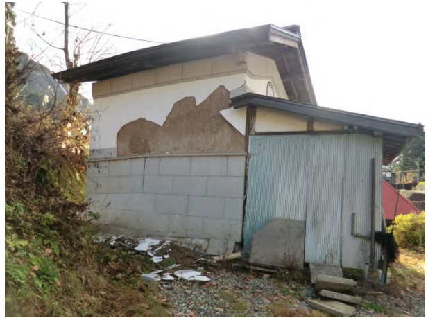
写真 22 納屋の壁の剥離 (小谷村真木)
