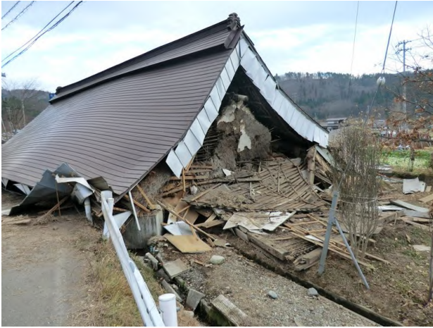
写真7 家屋の倒壊（白馬村神城堀之内）
