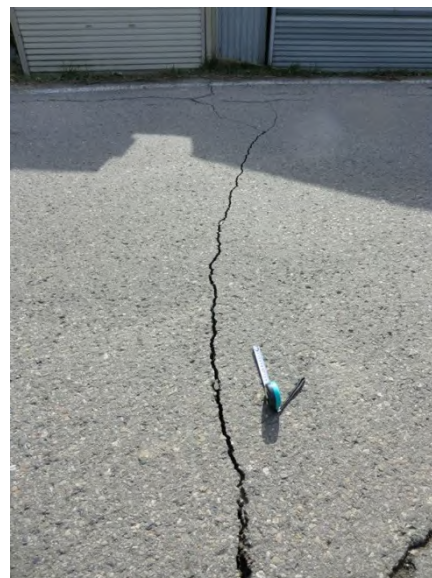
写真 18 道路の亀裂（小谷村犬川）
