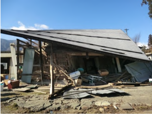
写真 13 家屋の倒壊（白馬村神城堀之内）
