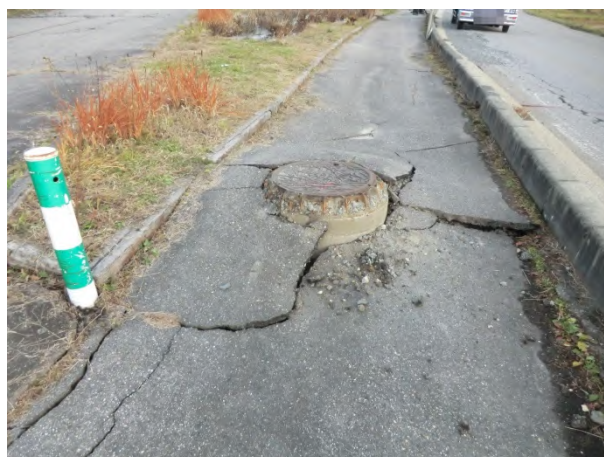
写真 39 液状化により飛び出したマンホール (白馬村神城堀之内県道 33 号線)
