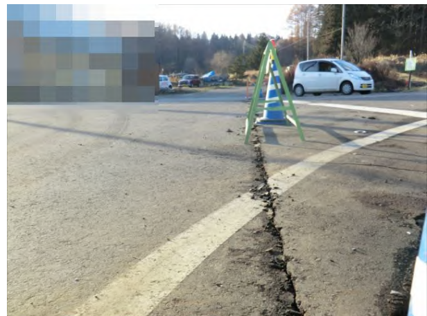
写真33 地面の亀裂（信濃町富濃）
