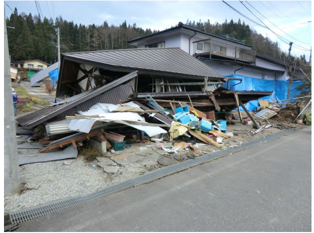
写真8 家屋の倒壊（白馬村神城堀之内）
