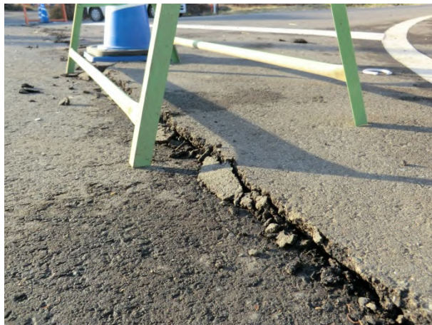
写真32 地面の亀裂（信濃町富濃）
