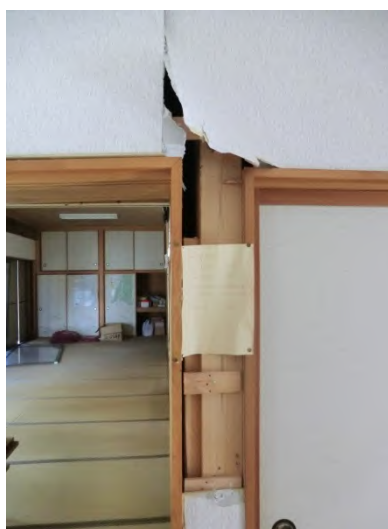
写真 29 公民館内の壁の剥離（長野市鬼無里）
