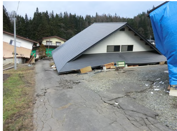
写真11 家屋の倒壊（白馬村神城堀之内）
