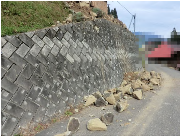
写真 19 石垣上部斜面からの落石 (小谷村真木)
