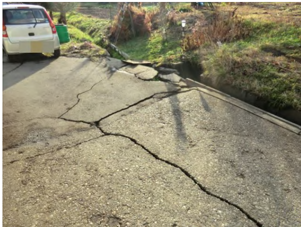
写真30 道路の亀裂（信濃町富濃）
