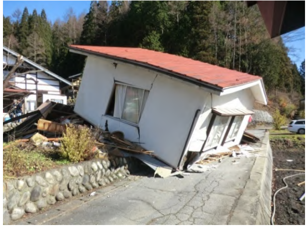
写真10 家屋1階部分の倒壊 （白馬村神城堀之内）
