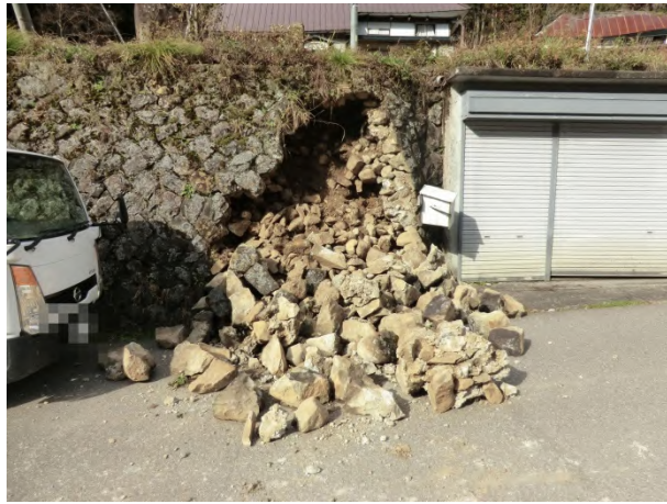
写真 21 道路脇石垣の損壊 (小谷村真木)
