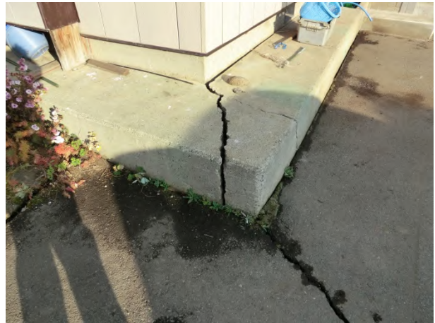
写真31 家屋コンクリート部の亀裂（信濃町富濃）
