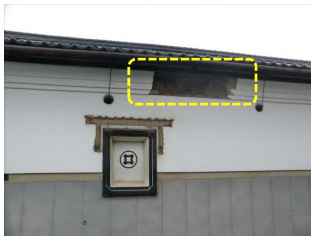
写真35 店舗の壁の剥離（豊野町豊野）
