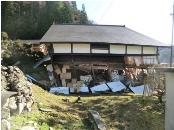
写真9 家屋の傾斜（白馬村神城堀之内）
