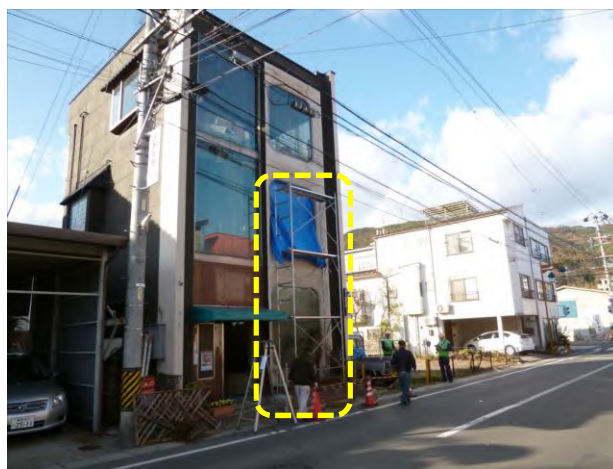
写真4 窓ガラスの破損（長野市箱清水）
