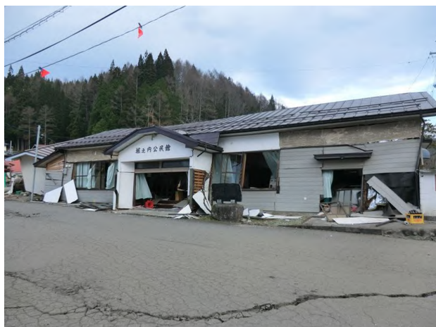
写真5 公民館の損壊（白馬村神城堀之内）
