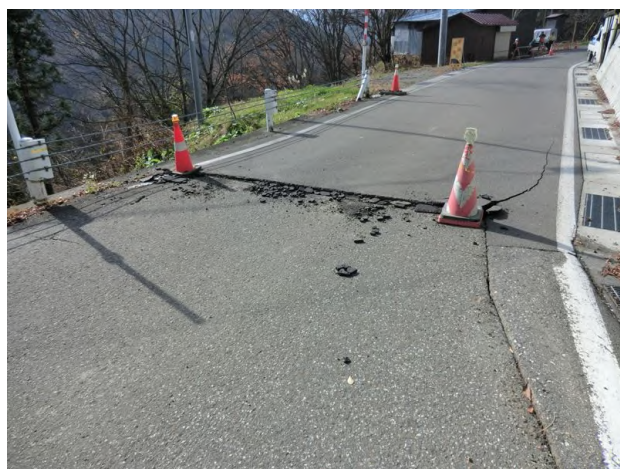
写真 17 道路の段差（小谷村犬川）
