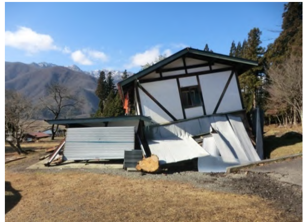
写真12 家屋1階部分の倒壊 （白馬村神城堀之内）
