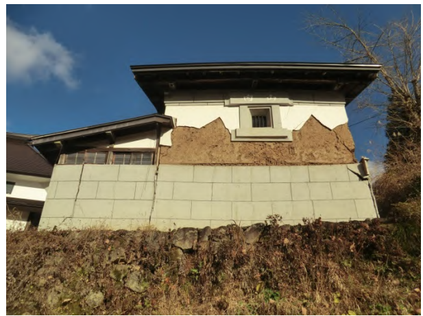
写真 20 家屋の壁の剥離 (小谷村真木)
