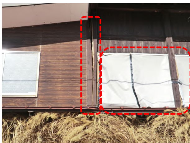
写真 28 公民館のガラス及び柱の破損 （長野市鬼無里）
