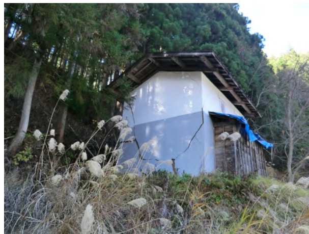
写真 23 納屋の壁の亀裂 (小谷村真木)
