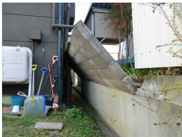
写真3 ブロック塀の倒壊（長野市箱清水）
