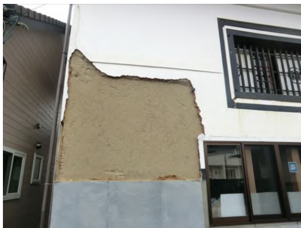
写真34 店舗の壁の剥離（豊野町豊野）
