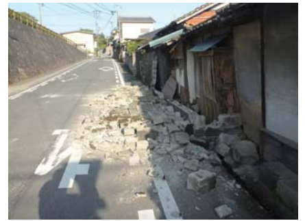
強い揺れにより倒壊したブロック塀 (2016年 熊本地震)
