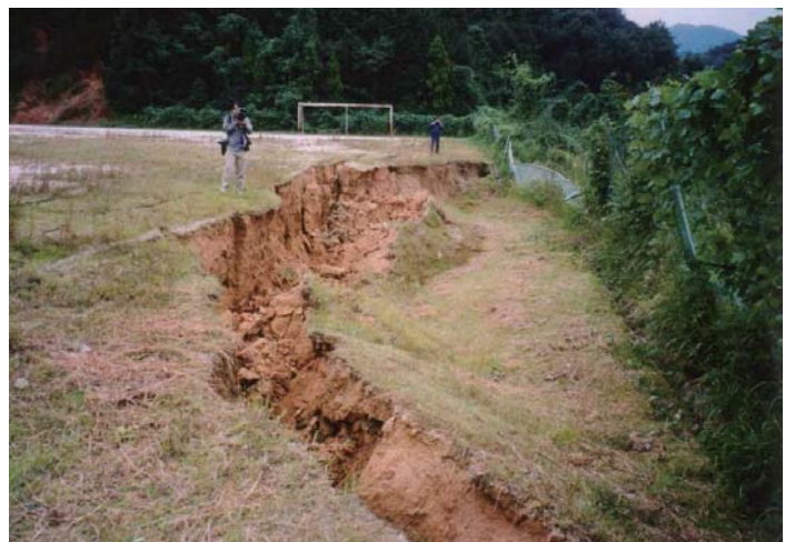
学校のグラウンドの地割れ（鳥取県西伯郡南部町）
