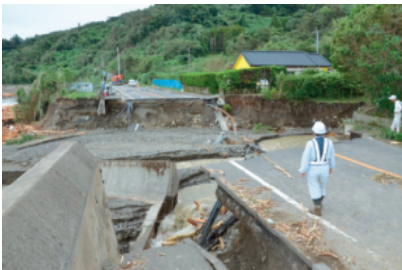
鹿児島県垂水市牛根地区の国道 220 号線、磯脇川の磯脇橋が流出 (提供：垂水市)
