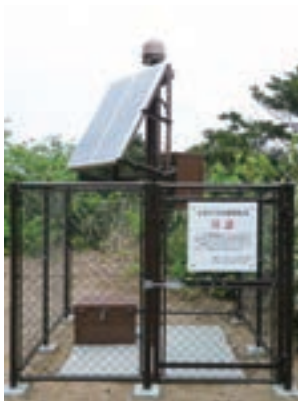
GNSS 観測装置
