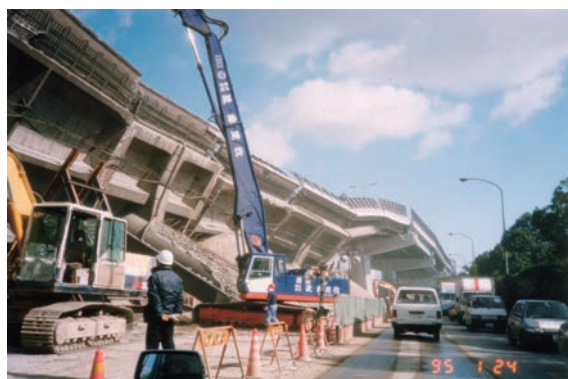
(上段)地震により倒壊した家屋等 (下段)地震により倒壊した高速道路
