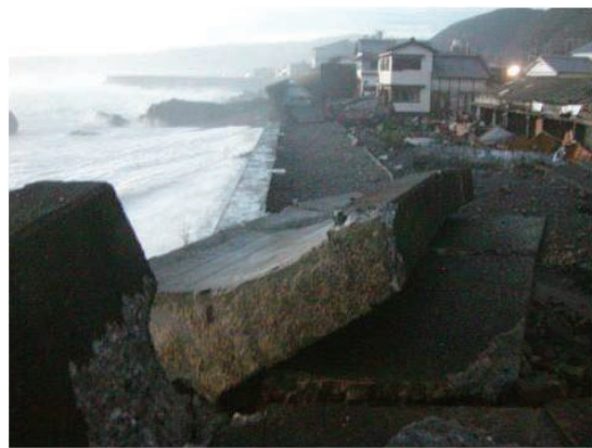
高知県室戸市 高波による防波堤の被害
