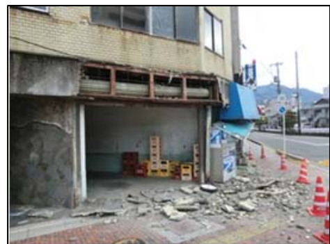
写真4 住家外壁の損壊と落下（呉市東中央）
