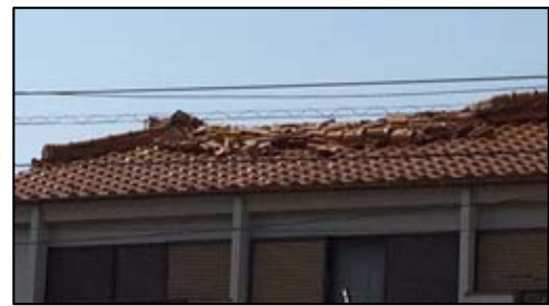
写真2 民家の屋根損傷（西予市三瓶町）
