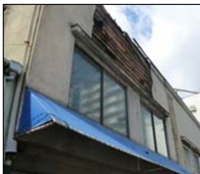
写真3 住家外壁の損壊と落下（呉市中通）
