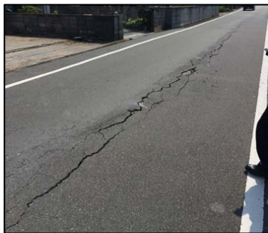
写真1 道路の亀裂（西予市三瓶町）
