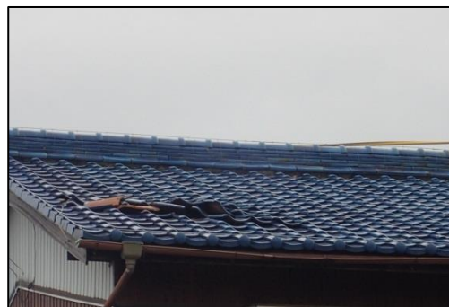
屋根瓦がめくれた住家（9/20 三重県鈴鹿市）
