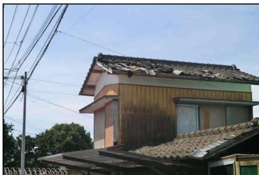
屋根瓦がめくれた住家（9/19 宮崎県宮崎市）
