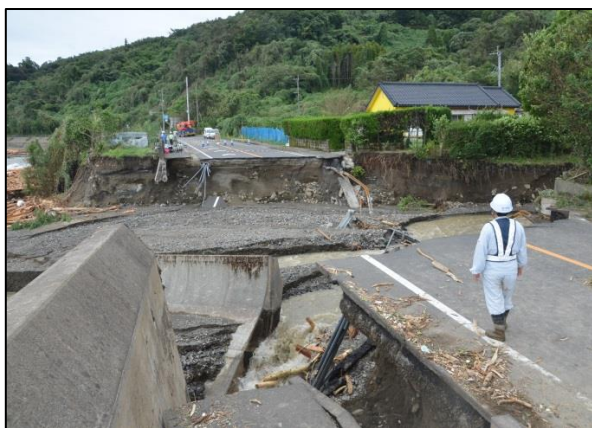
鹿児島県垂水市牛根地区の国道 220 号線、 磯脇川の磯脇橋が流失 (提供：垂水市)
